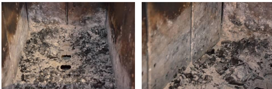
Slika 19: Gorilna rešetka (levo) in stranski dovodni kanali (desno)
